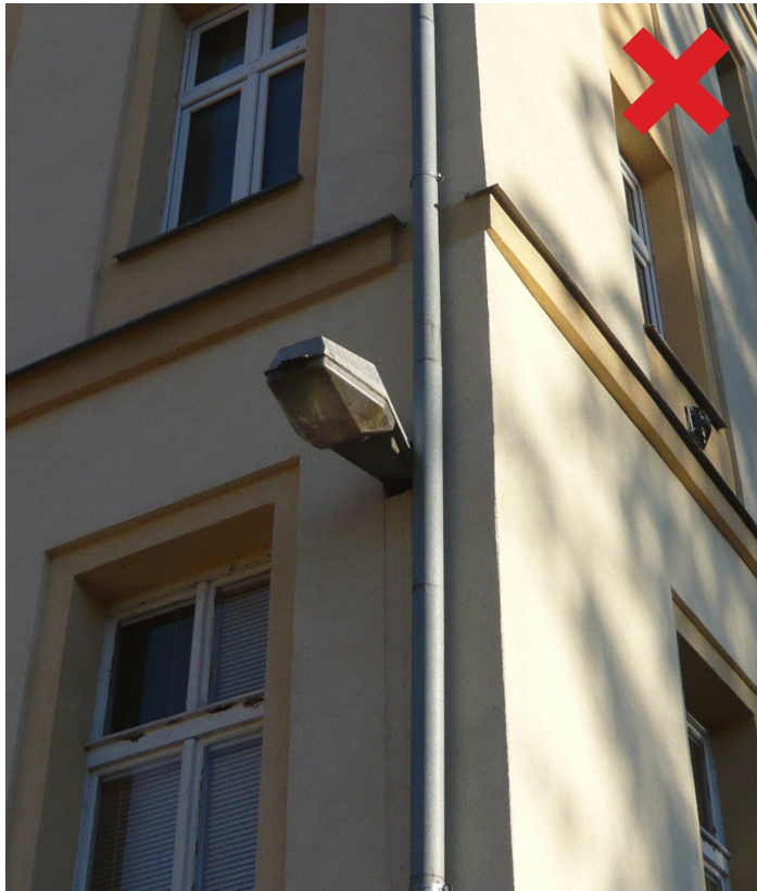
Obr. 6, 7 a 8 Nejednotné řešení veřejného osvětlení
