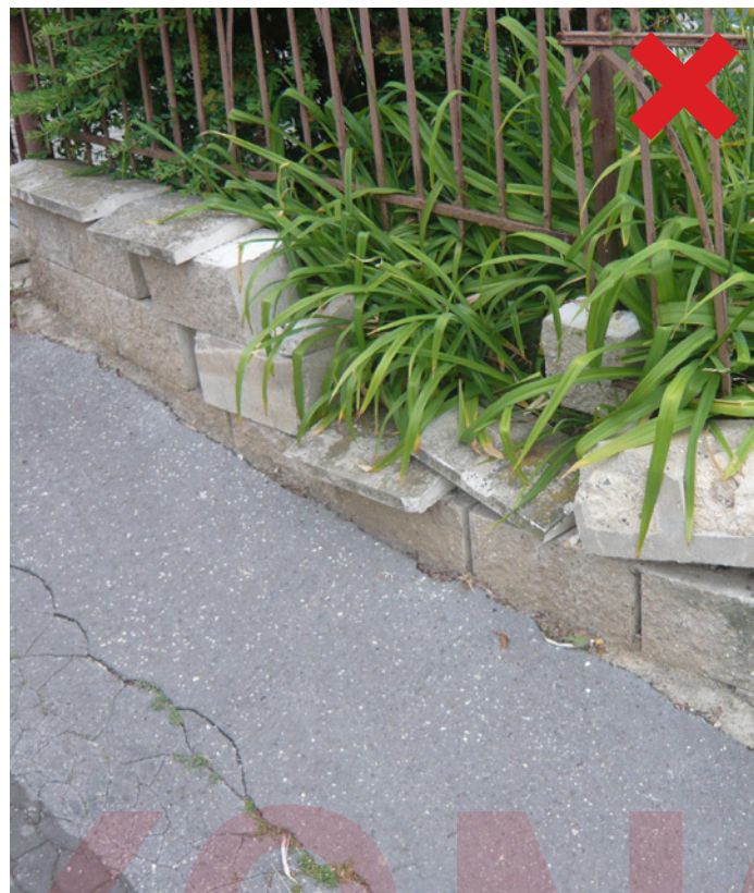
Obr. 7 Oplocení ve špatném technickém stavu
