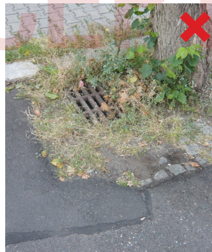
Obr. 4 Uliční vpust' zarostlá v trávě v těsné blízkosti kořenů stromu
