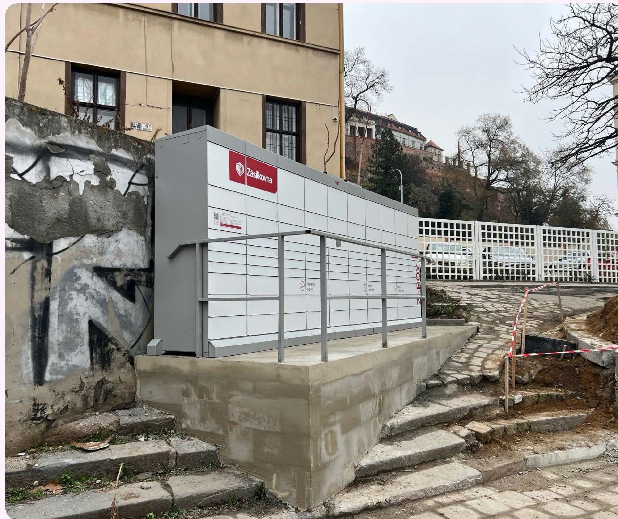
Ukázka nepečlivého a bezohledného umístění do konkrétního místa – na veřejně přístupné schody mezi dvěma ulicemi. Instalace vytváří bariéru a ztěžuje přístup kurýrovi i zákazníkovi.
